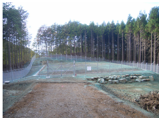
▲吉崎国有林内に設置された仮置場
