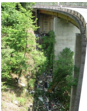
▲国道254号内山バイパス 橋下の不法投棄 (平成25年5月22日撮影)
