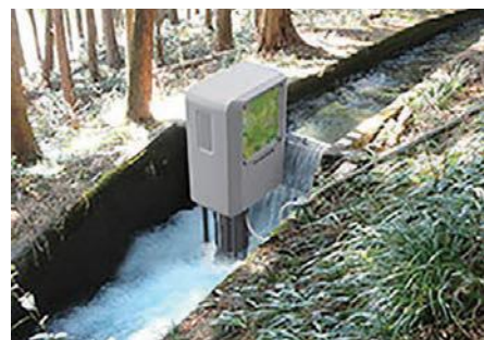
水路を活用した小水力発電の例
