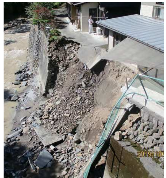
南野牧三ツ瀬地内敷地とともに、浄化槽が流失した現場
