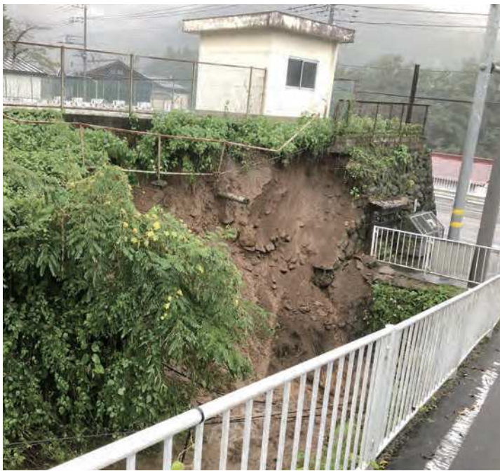
台風19号災害により石積が崩れた旧小坂小プール脇
