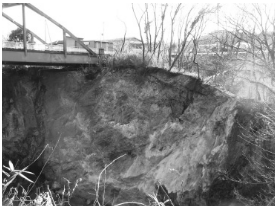
不通橋の崩落現場
