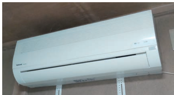
古く効率の悪いエアコン
