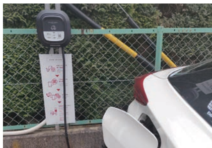
EV普通充電器
