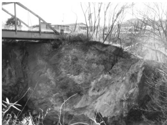
不通橋の崩落現場
