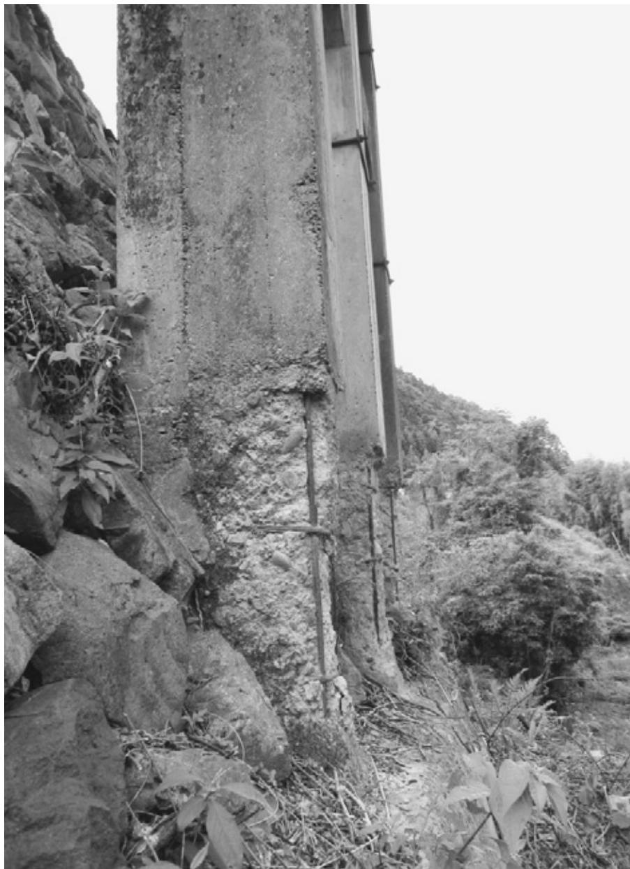
再度通行止めの危険な万年橋「橋脚」
