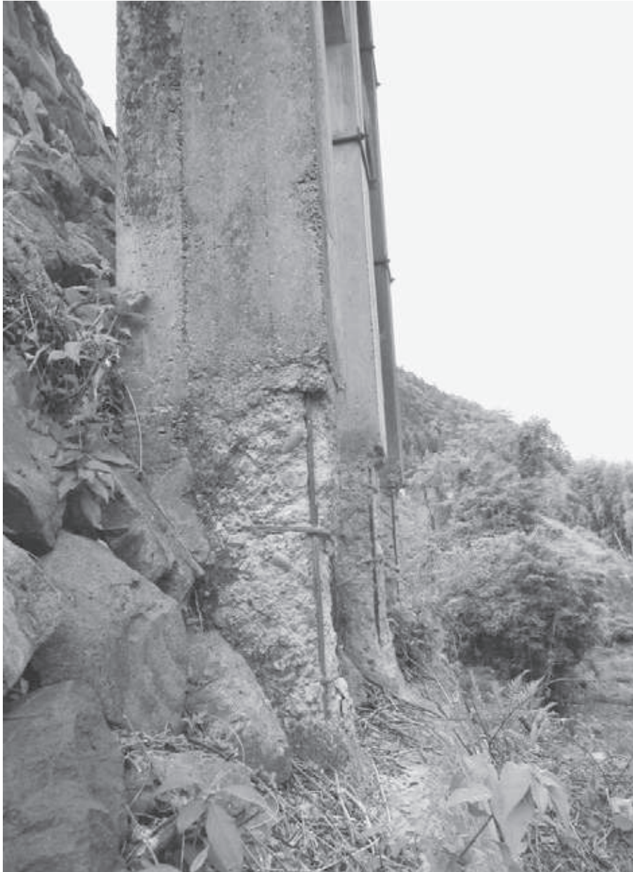
再度通行止めの危険な万年橋「橋脚」
