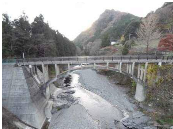
南牧川に架かる萬年橋（昭和8年竣工） （ドローンを使用して点検・撮影）
