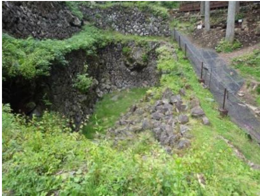
③ 2号風穴北面（崩落石積み）
