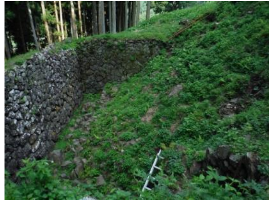
④ 3号風穴南面（崩落石積み）
