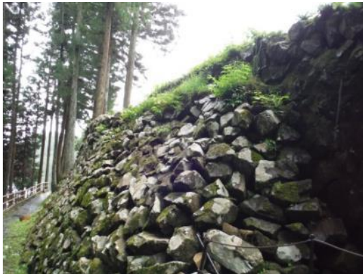
① 3号風穴北面補強石積み（孕み）
